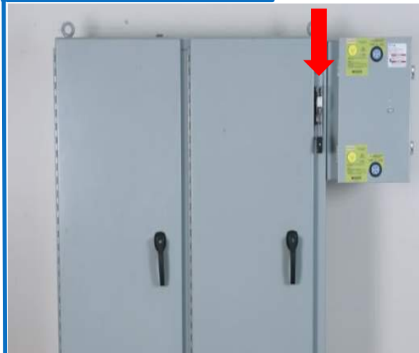
OLI (Control Panel) Switch
